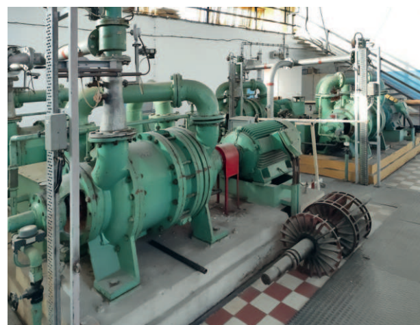
5. ÁBRA. A vákuumrendszer szivattyúi (A szerző archívumából)
