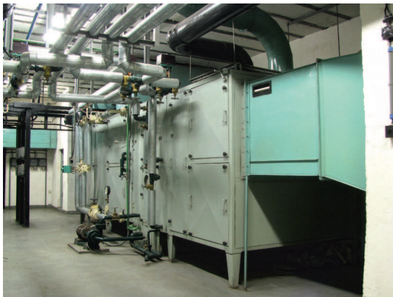
8. ÁBRA. A Prágát és környékét védő 71. légvédelmi rakétadandár Drnov melletti harcálláspontjának háromszintes létesítményében látható klímablokk a hozzacsatlakozó vízcsovekkel és légvezetékekkel (A szerző felvétele)
