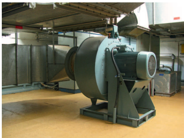
9. ÁBRA. Nagy teljesítményű ventilátormotorok gondoskodtak a szükséges levegőmennyiség beszívásáról a Garzau melletti kétszintes föld alatti objektumban (A szerző felvétele)
