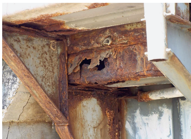
7. ÁBRA. Súlyos, lokális korrózió a sajóecsegi Sajó-hídon [17]
