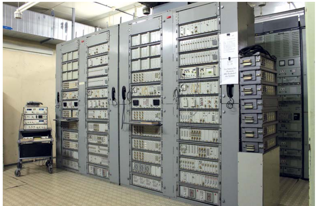
5. ÁBRA. Impozáns, szinte szobányi méretű az „Azúr - 60 SzR” típusú csatornaképző berendezés, amely biztosította a digitális adatátviteli csatornák létrehozását, rendezését (A szerző felvétele)
