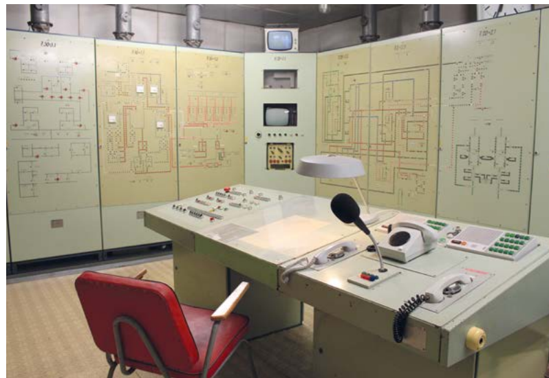
10. ÁBRA. A wollenbergi 301-es BARSz állomás védett létesítményének diszpécserközpontja az irányítópulttal, ahonnan a kétszintes bunker működését felügyelték, vezérelték (A szerző felvétele)
